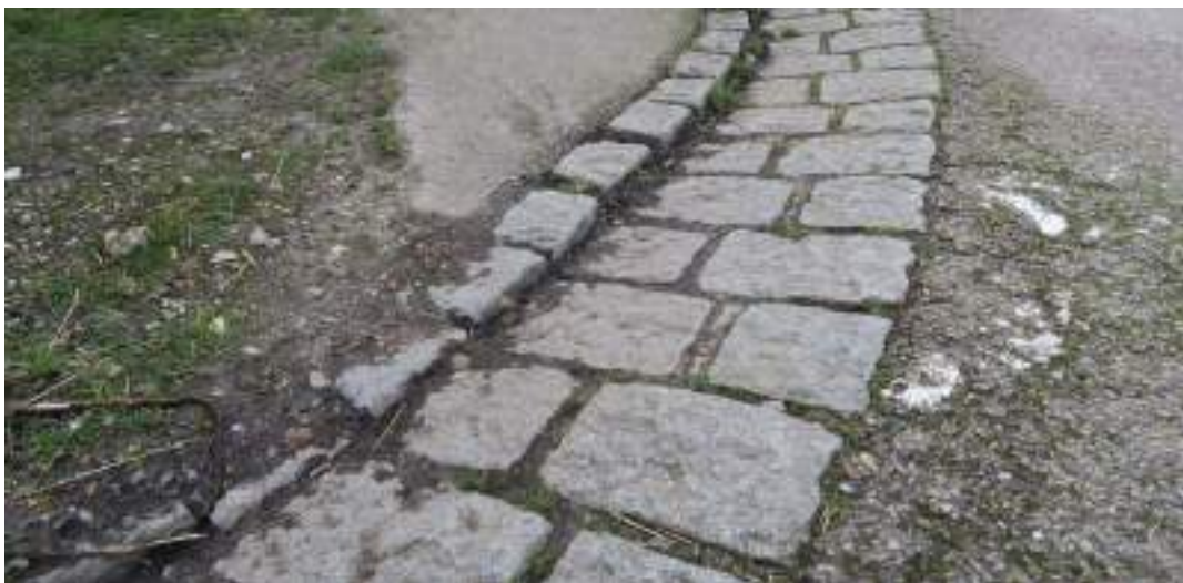
Trottoir dégradé à Bourg-Achard
